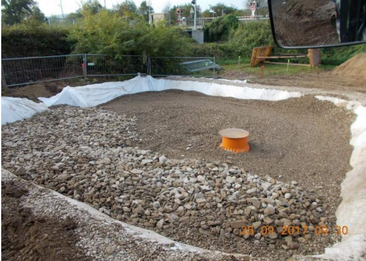
Versickerungsanlage mit Spül- und Reinigungsschacht
