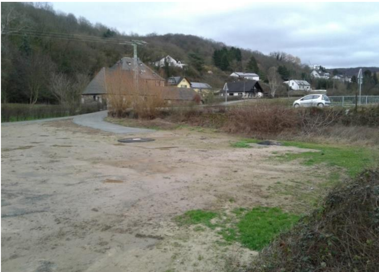
Fertiggestellte und in Betrieb befindliche Versickerungsanlage
